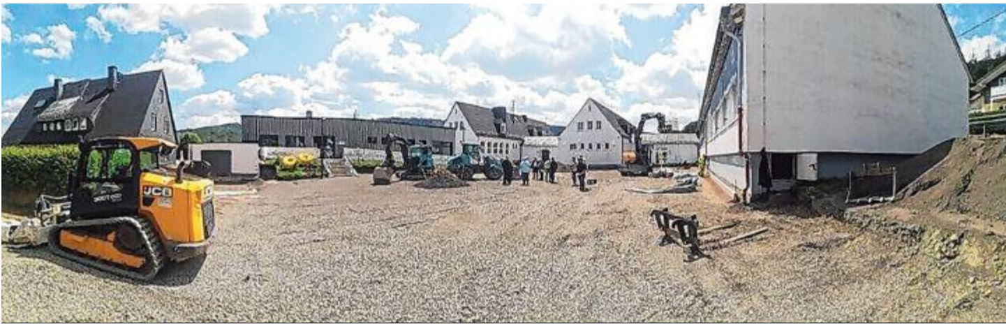
Die Asphaltdecke wurde bereits entfernt. In den nächsten Wochen wird der neue Schulhof knallbunt!
